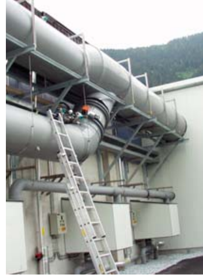
Industrierohrleitung Ø 1200 (PPs)
