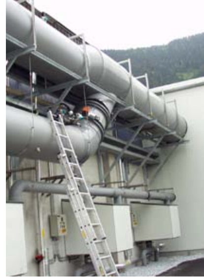
Industrierohrleitung Ø 1200 (PPs)
